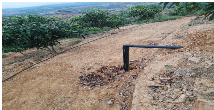
图6 裸露于梯带影响机具通行作业的水管
