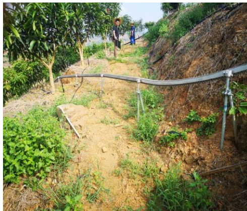
图 1 横于梯带路面上的轨道运输线
