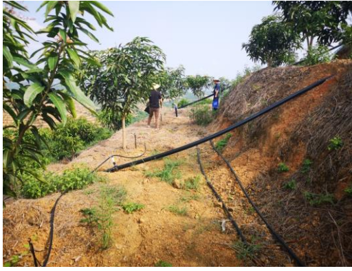
图4 裸露于梯带影响机具通行作业的水管
