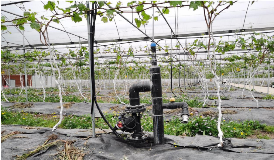
水肥一体化系统
